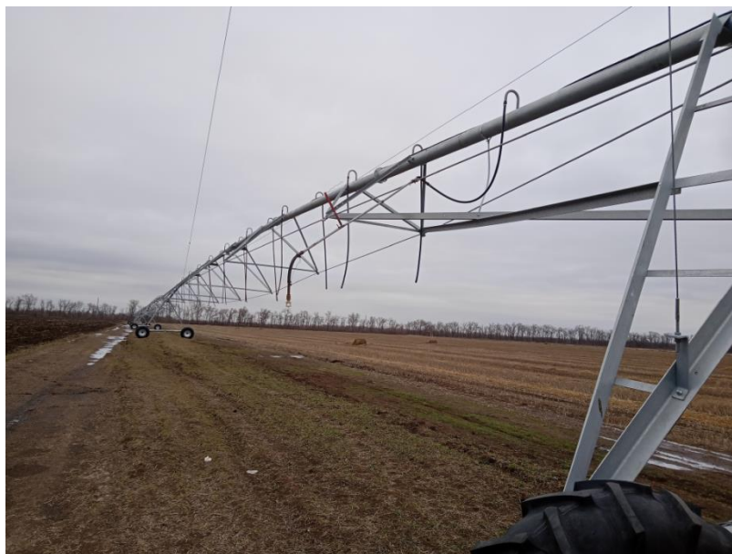
Рисунок 2.14 – Монтаж устройства приповерхностного дождевания в районе тележки (высота установки насадки 2,5 м от поверхности земли)
